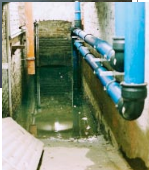
Historisches Speicherbecken als Regenwasserzisterne, die die Wärmepumpen bedient
