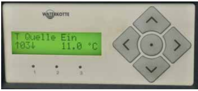
4. Februar 2010: Wassereintritt 11,0°C, Wasseraustritt 8,5°C.
