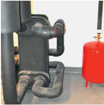
Trennwärmetauscher Grundwasser / Wärmepumpe.
