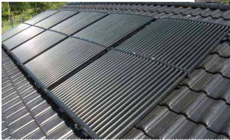
Absorber-Kollektoren auf einem Dach montiert
