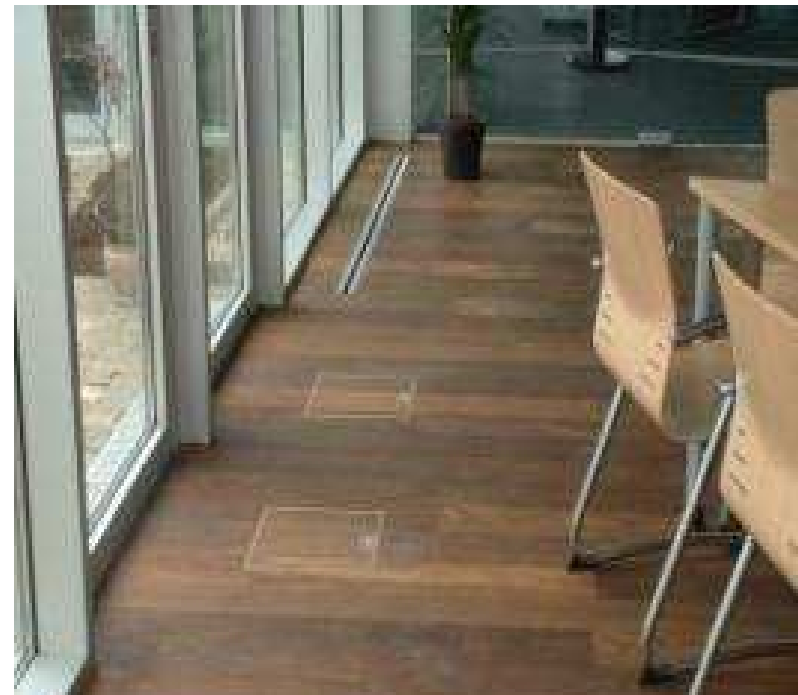
Luftauslässe am Fenster
