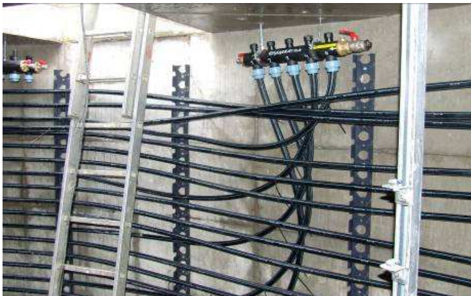
Die Wärmetauschrohre im Inneren des Eisspeichers
